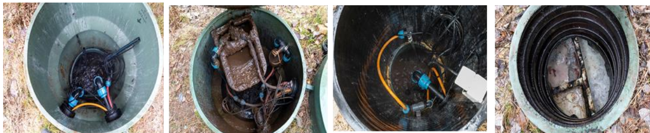
Kuva 3.2. Jätevesikaivot: esikäsittely, prosessikäsittely, varastosäiliö ja rasva.
